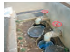
井戸(貯水槽排水出口)
