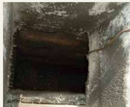
平衡方式設置30年 経過後のダクト内部 状況
